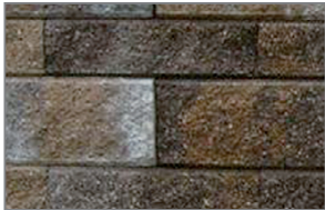
Kerítés hidrofbizálás nélkül
